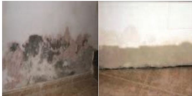
Figura N°1: Humedad del suelo producto de la capilaridad. [1]
